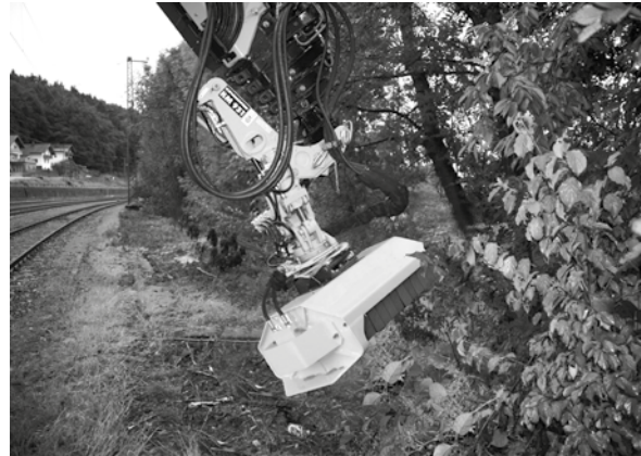
SLA 4 montiert am Manipulator (Kranarmanbau)
